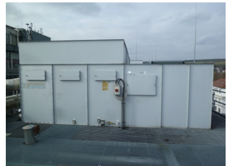
Austausch nach 40 Jahren des Kühlturm DT 4/77 Z 4-6086-Bj. 1979
